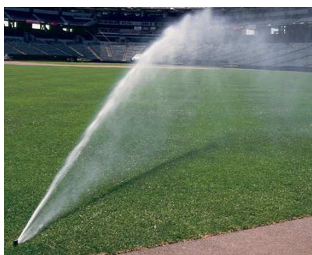
Abbildung 6 Fest installierte Beregnungsanlage (mnrainman, 24.04.2013)
