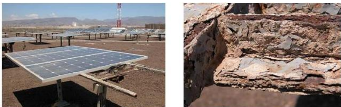
Abbildung 2-13: Korrosion an der Trägerstruktur von PV-Modulen nach zehn Jahren [ITC08]
