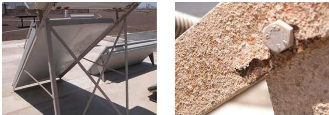
Abbildung 2-9: Korrosion an Rahmen und Trägerstruktur von Solarkollektoren [ITC08]
