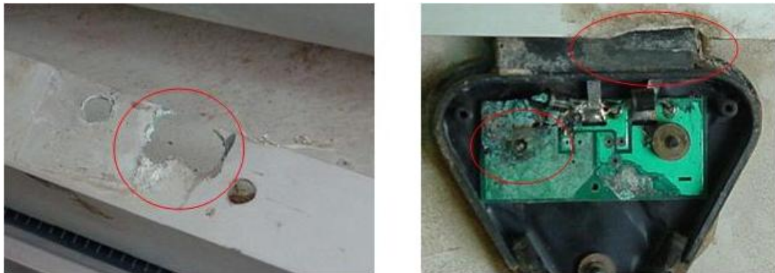
Abbildung 2-12: Korrosion an verschiedenen Komponenten von PV-Modulen nach 3,5 Jahren [ITC08]
