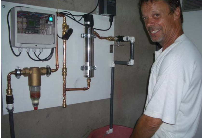
Die Trinkwasseraufberei- tungsanlage bezieht ihr Wasser ebenfalls aus dem Hochtank. Die Desinfizierung des Wassers geschieht vollautomatisch.
