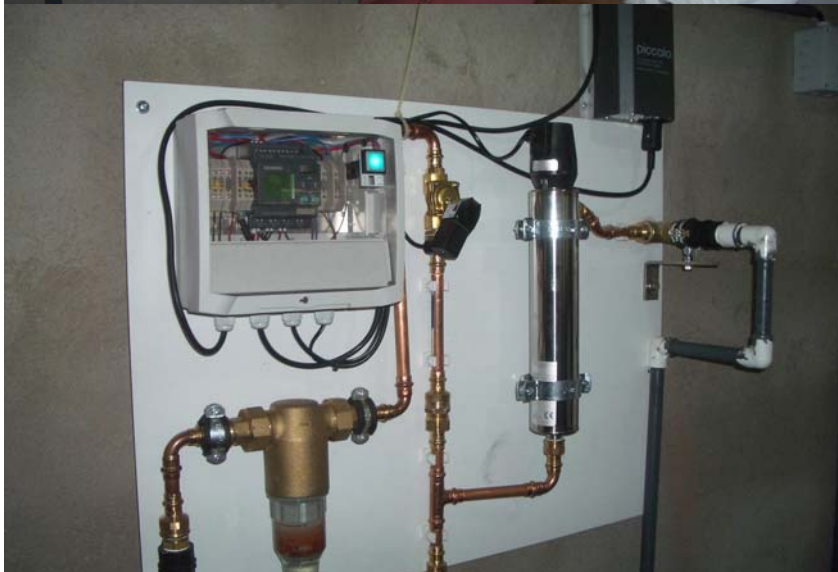
Drei mal am Tag geht die Anlage in Betrieb. Das saubere Trinkwasser soll die häufigen Erkrankungen drastisch reduzieren.
