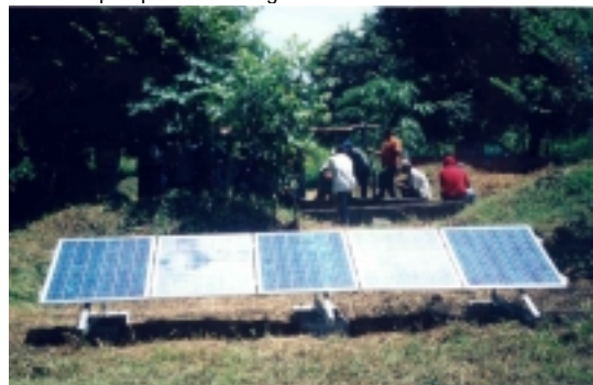
Der Solargenerator der Tauchpumpe
