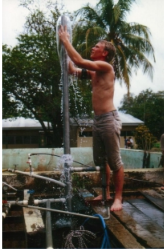
Im Mai 2002 installierten Schüler der GS Blankenese erstmals ein solargestütztes Pumpsystem auf dem Universitätsgelände von Leon
