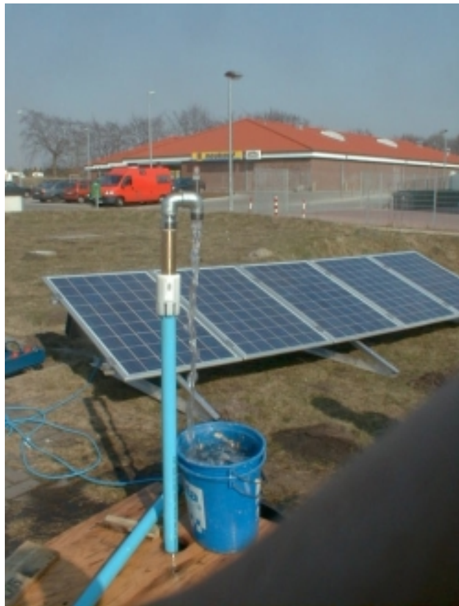
Testaufbau der Grundfos-Pumpe auf dem Firmengelände der SET GmbH
