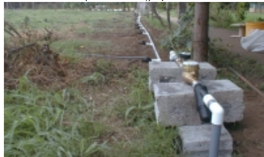
Das neue Tropfbewässerungssystem der UNAN
