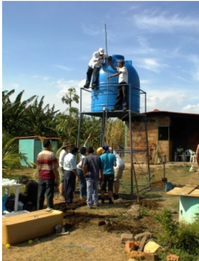
Aufbau des Hochtanks auf der Finca
