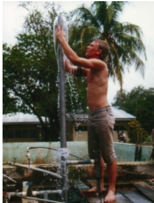
Im Mai 2002 installierten Schüler der GS Blankenese ein solargestütztes Pumpsystem auf dem Universitätsgelände von León
