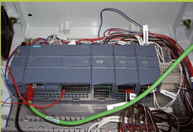
02 Zur Überwachung und Steuerung der entfernten Anlagen in Nicaragua kommt die Fernwirktechnik TeleControl Basic von Siemens zum Einsatz
